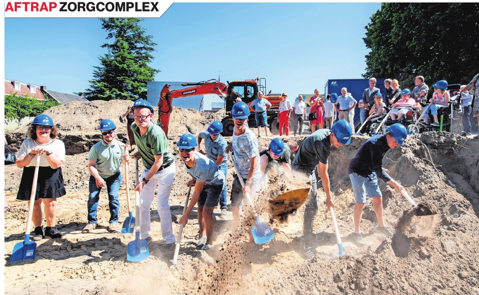
▲ Toekomstige bewoners steken de eerste schop in de grond, ook vanuit de rolstoel (op de achtergrond). FOTO RENÉ SCHOTANUS/PIX4PROFS
